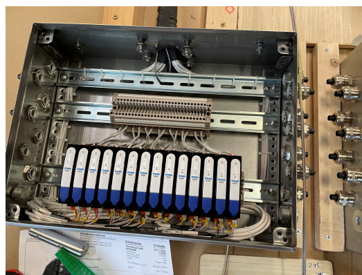
Montageexempel på hur signalomvandlarna sitter väl skyddade i den IP-klassade kopplingslådan.
